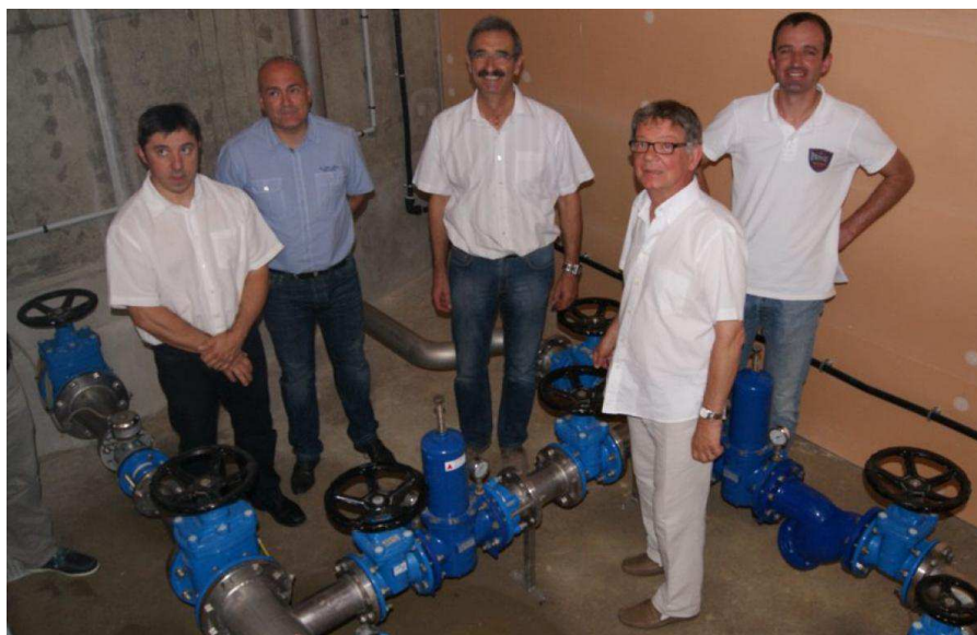
La visite s'est poursuivie dans le local technique où se situe toute la machinerie du réservoir de 400 m 3 Photo DDM
