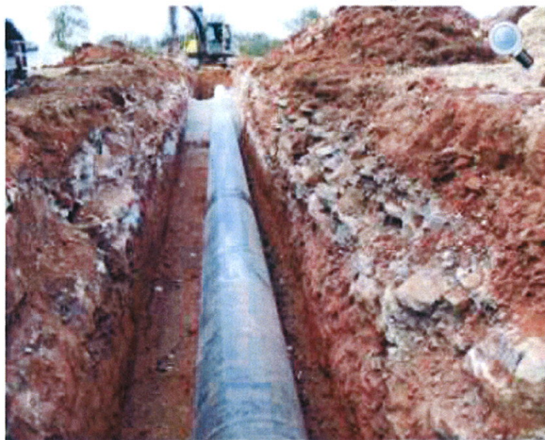
Bozouls. 32 000 abonnés sur un réseau d'eau désormais sécurisé
